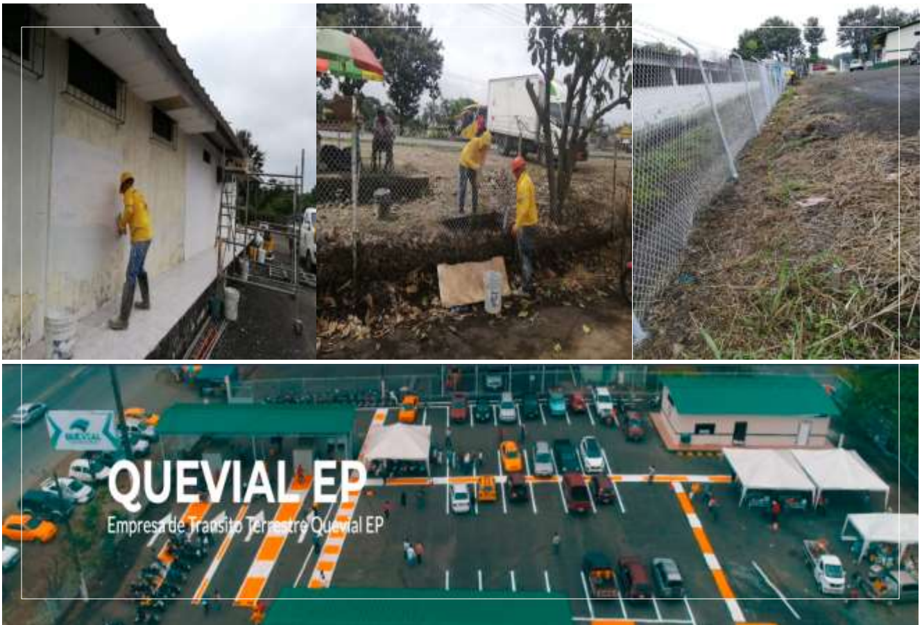
Anexo 10. Limpieza integral y pintura de las instalaciones de matriculación y revisión vehicular
