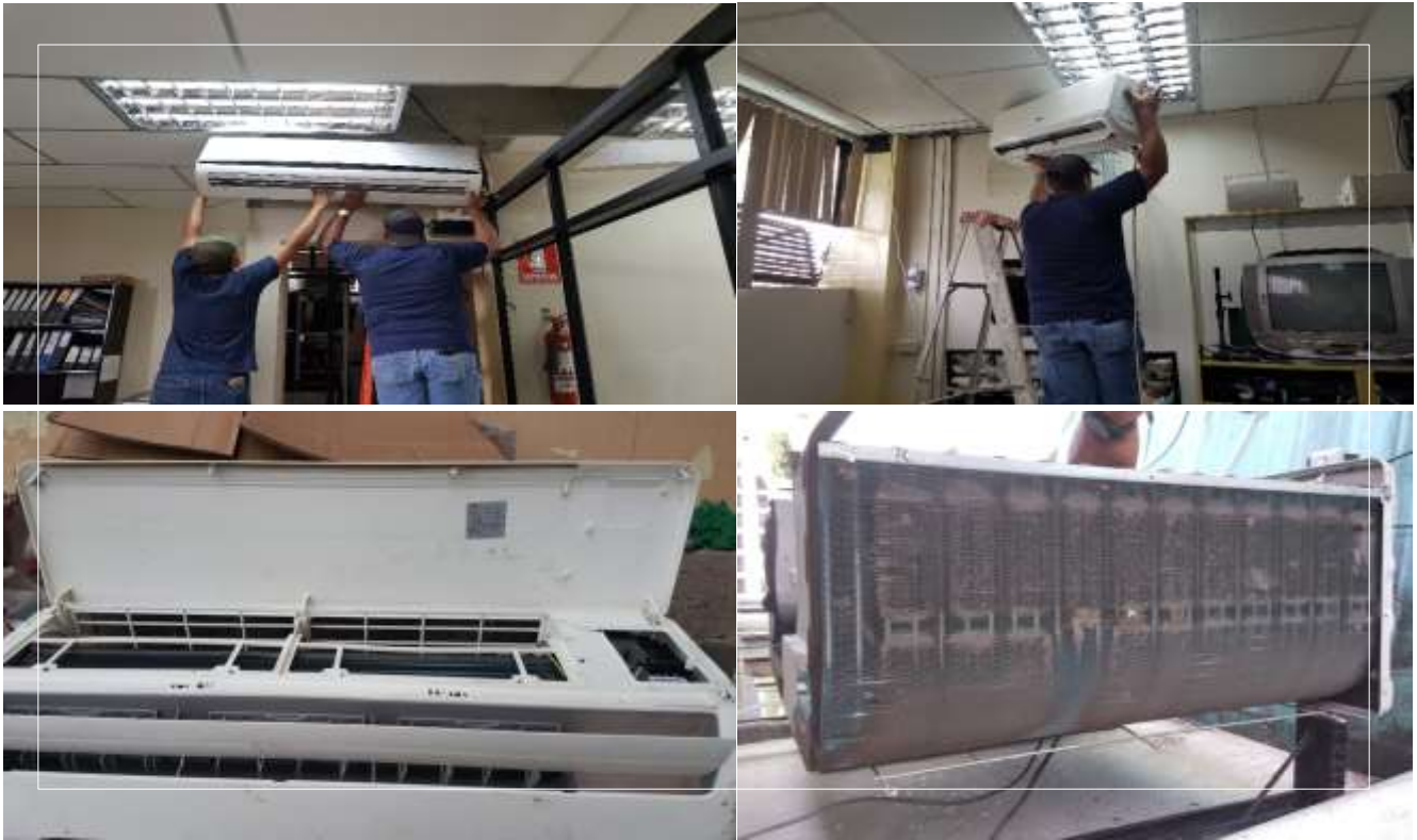
Anexo 22. Mantenimiento de Acondicionadores de aire
